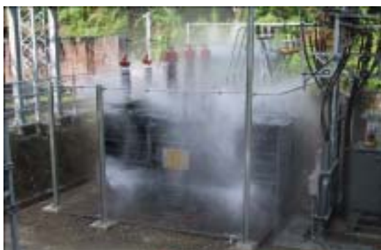
圖2.43由細水霧防護之通電中變壓器
