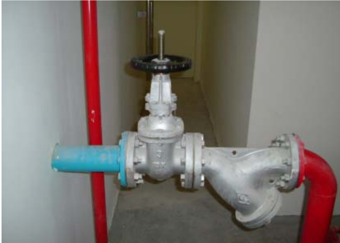
圖 7.6 消防水系統滅火設備配管之昇桿式閘閥、Y型過濾器
