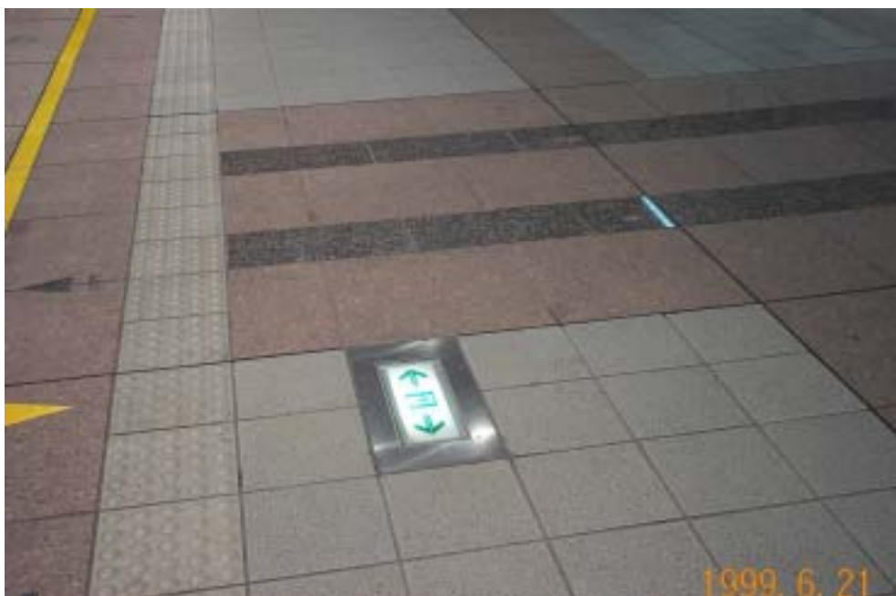
圖 7.10 嵌入地板式避難逃生標示設備
