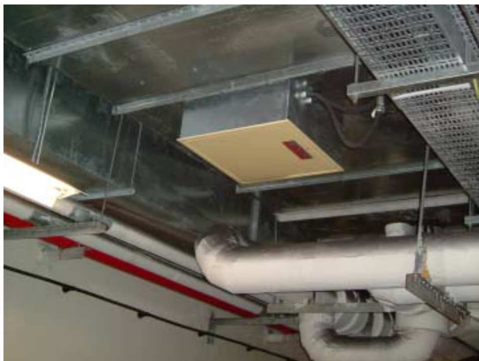
圖 7.13 無天花板且管線複雜區之排煙口
