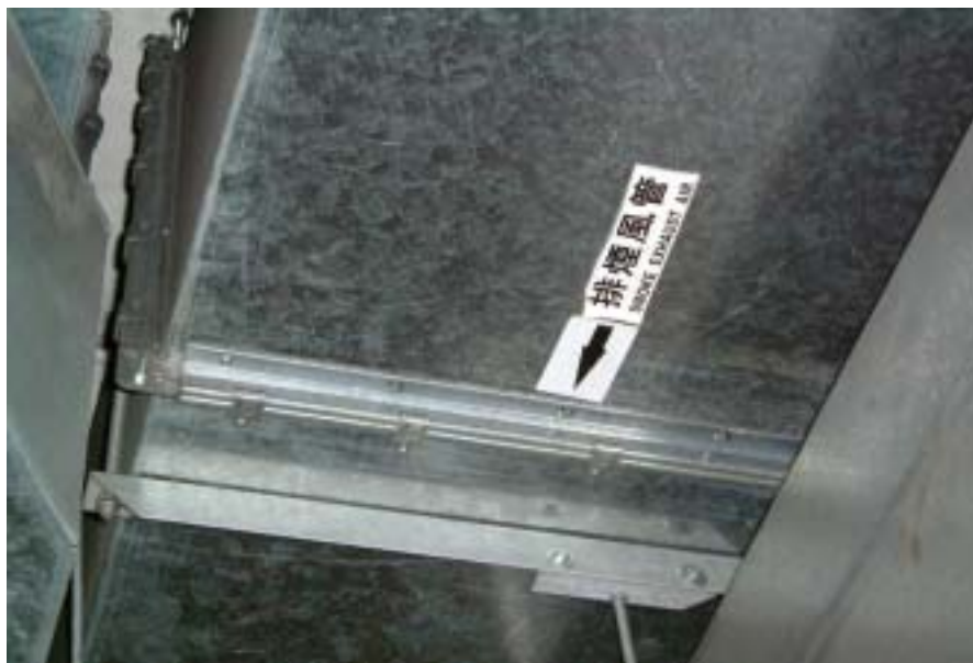
圖 2.57 採用 C 型夾扣接接合之排煙風管
