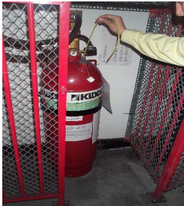
圖 2.47 低污染氣體滅火設備儲存鋼瓶之液面顯示計
