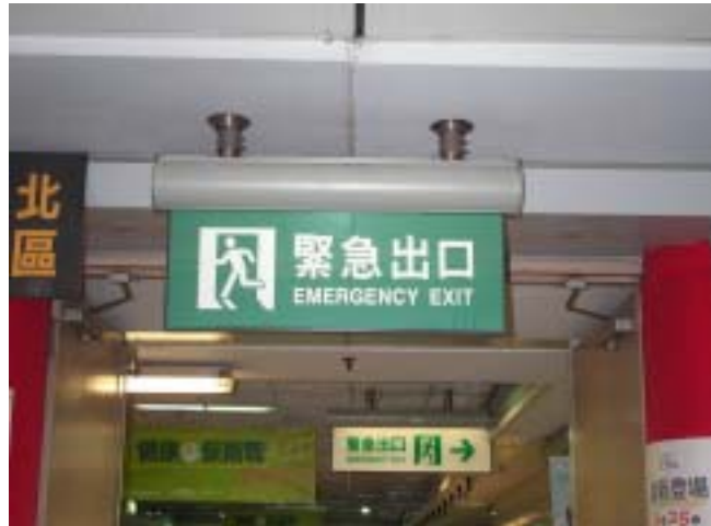
圖 2.48 安裝於緊急出口上方之出口標示燈
