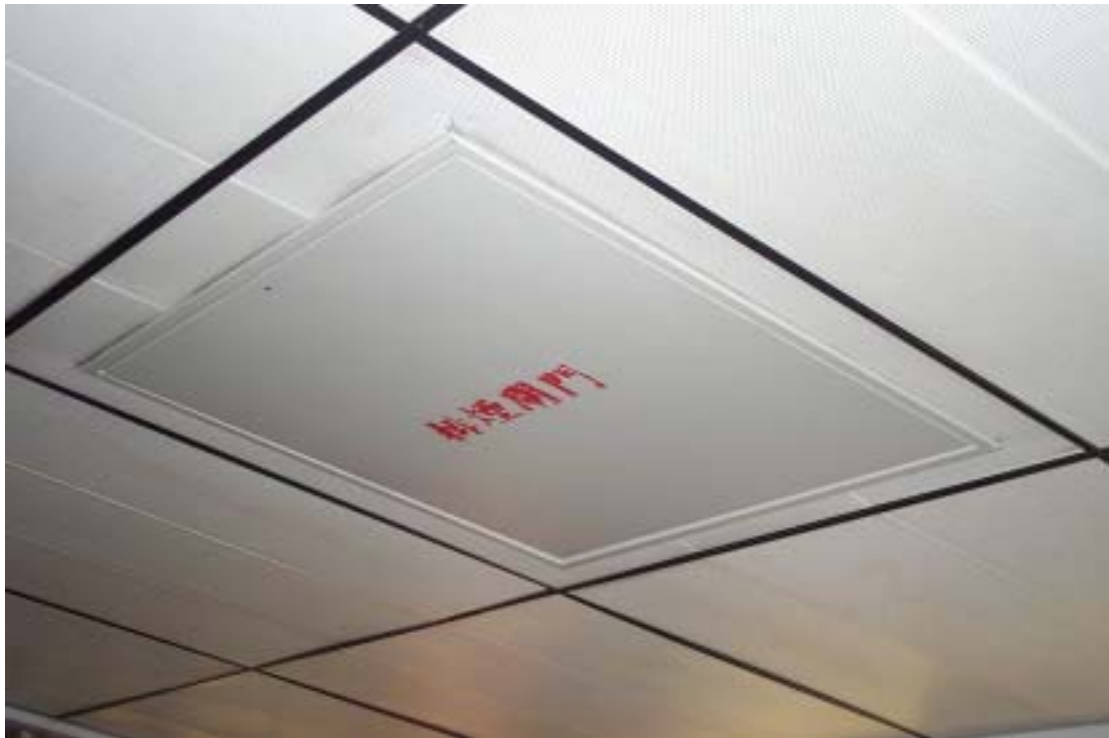
圖 2.52 單片式排煙口
