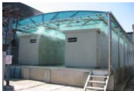
圖2.44由細水霧防護之通電中裝甲開關箱
