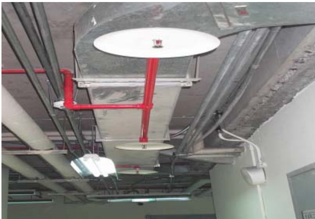
圖 7.7 撤水障礙加裝集熱板之案例
