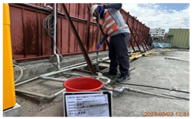
圖10-工區放流水監測
