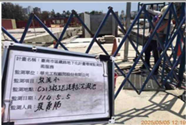
圖13-工區放流水監測
